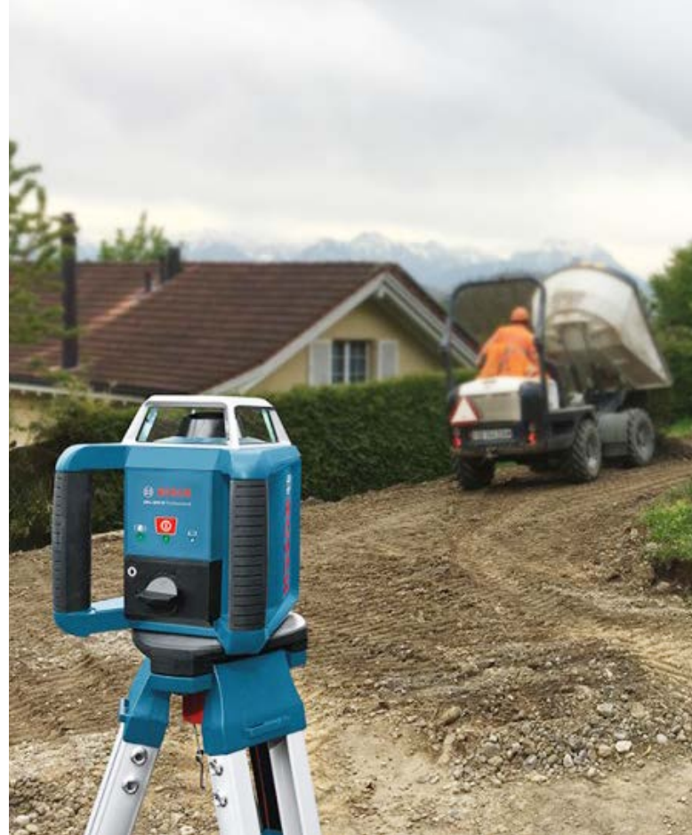
↑ Enlèvement de terre pour atteindre le niveau souhaité
